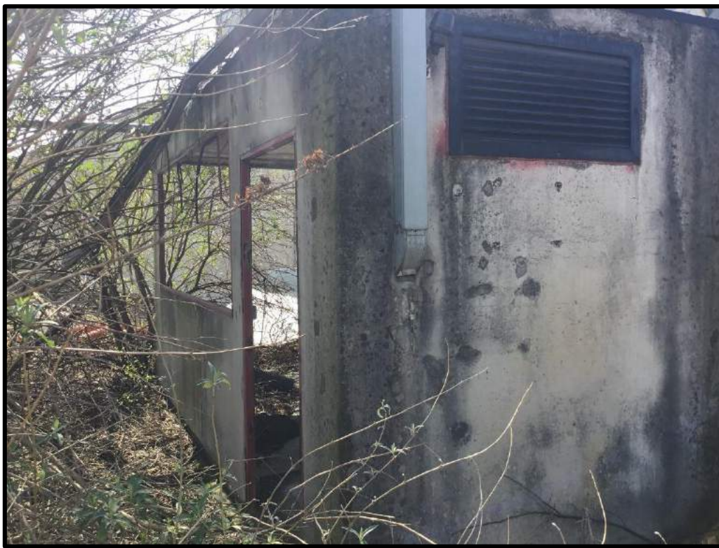
FOTO 156 – Vista locale quadri elettrici edificio O
