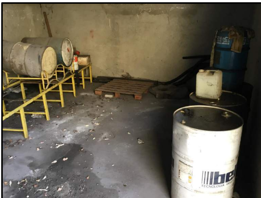
FOTO 57 – Interno deposito oli
