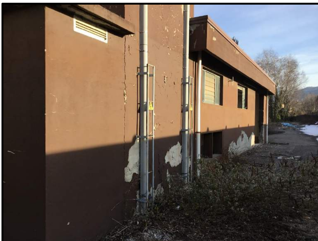
FOTO 9 – Cabine Enel ed edificio G
