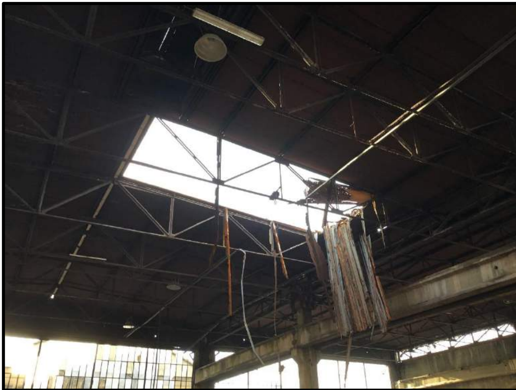
FOTO 31 – Particolare copertura crollata edificio R
