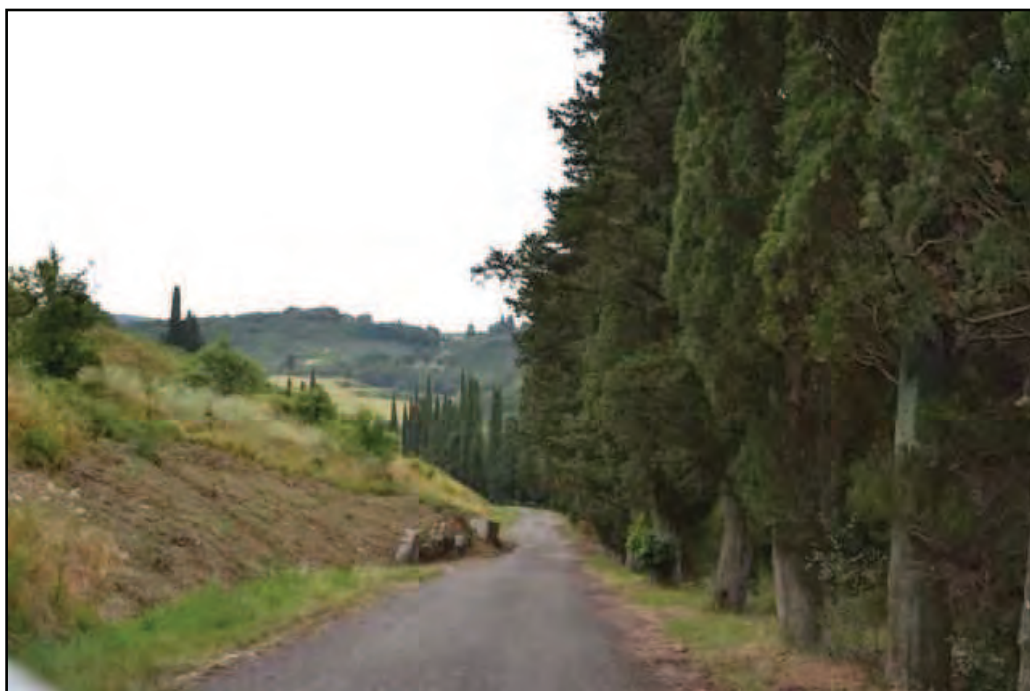
Fotografia n. 9 Vista dal basso dello smottamento del viale cipressato
