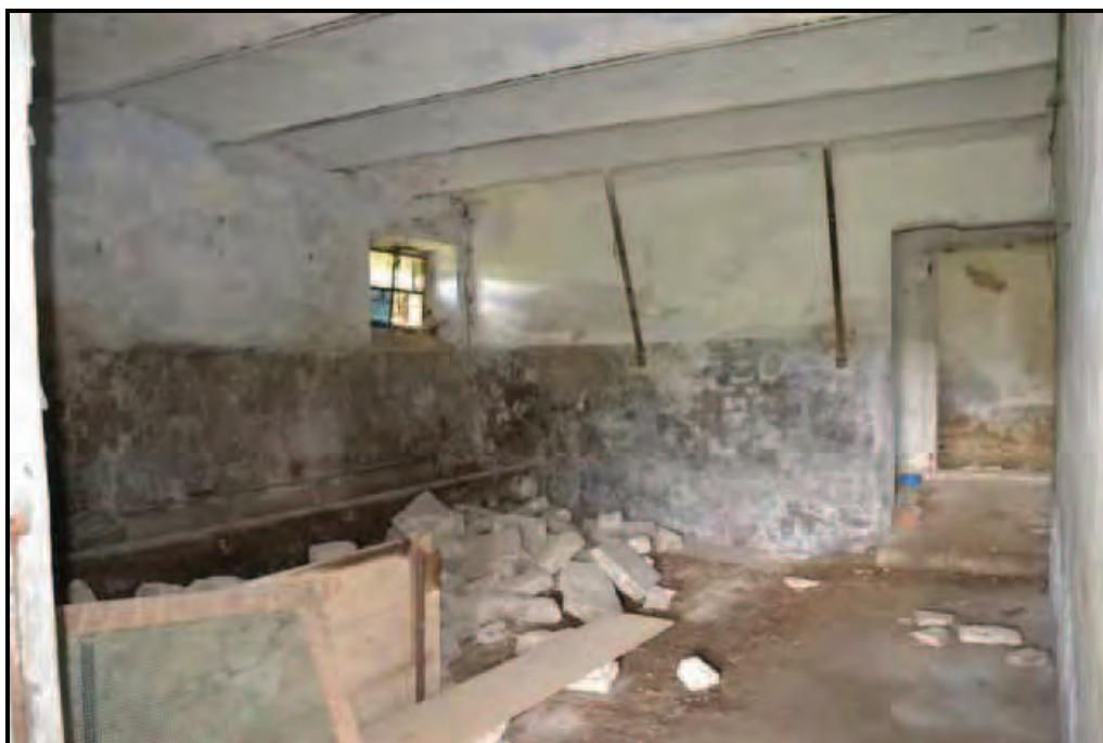
Fotografia n. 6 Podere Gaville – U.I. F. 63/59/501, deposito al piano terreno
