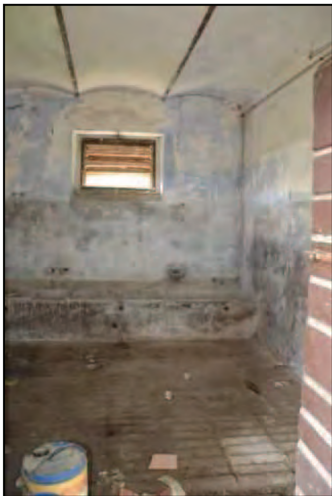
Fotografia n. 5 Podere Gaville – U.I. F. 63/59/501, deposito al piano terreno
