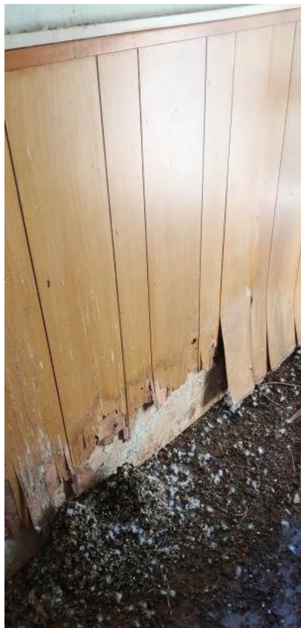
Foto del degrado interno
