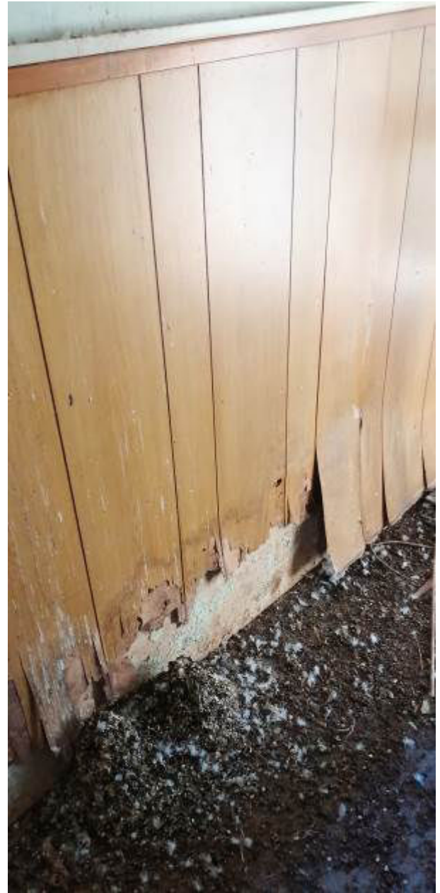
Foto del degrado interno
