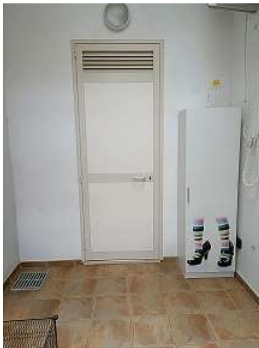
Foto 7 – locale tecnico nell’intercapedine p. S1
